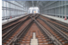
富山県高岡市 鉄道機器株式会社 富山工場
