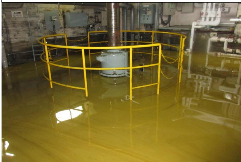
2017年度 水力発電所の水車フロア浸水状況
