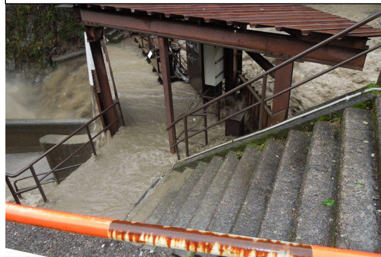
2017年度 水力発電所の取水設備浸水状況
