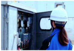
変圧器の設備点検
