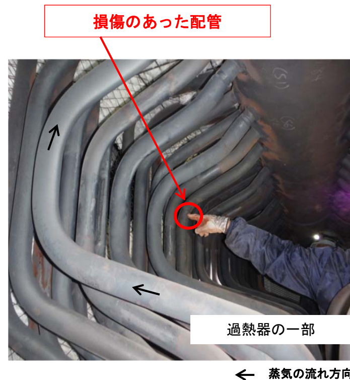
損傷箇所(拡大写真)
