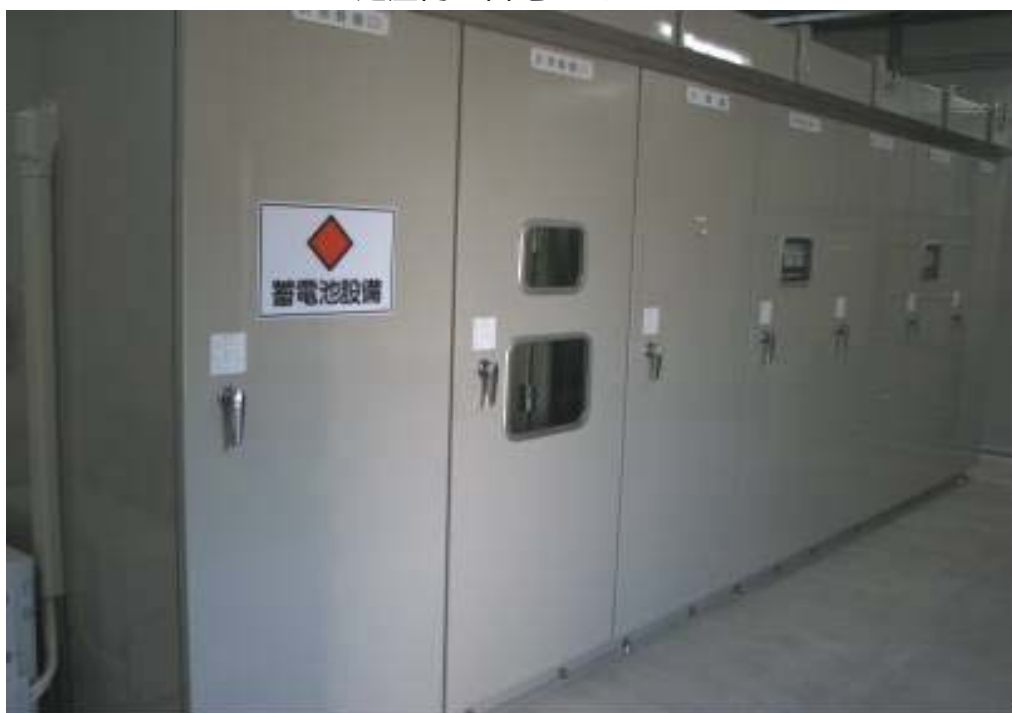
建屋内の蓄電システム
