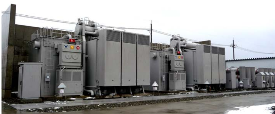
黒部変電所新設（連系用変圧器）
