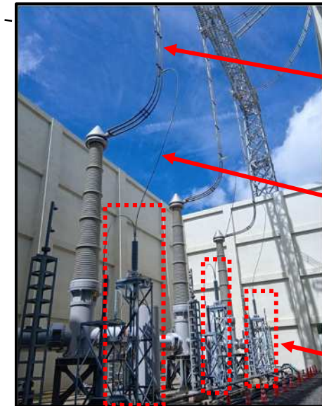
志賀中能登線ケーブル接続状態
