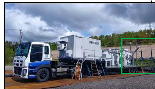
移動式変電所 外観
