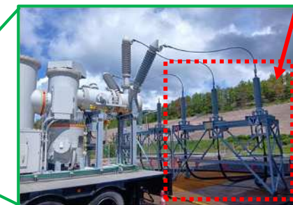
移動式変電所ケーブル接続状態
