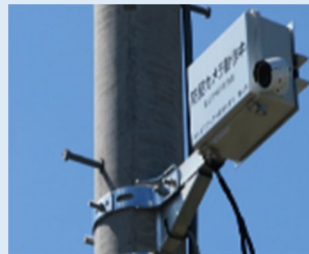
防犯カメラ設置
