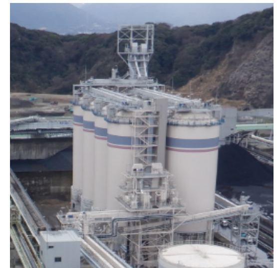
（敦賀火力発電所：設置完了）
