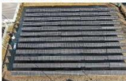
弊社敷地内に設置した太陽光発電所(1,024kW)
