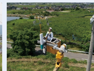
送配電設備の巡視・点検
