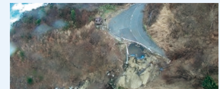
ドローンによる被害状況確認
