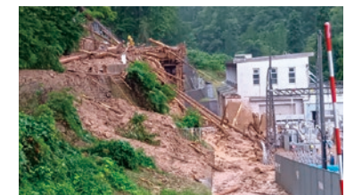
白峰発電所・変電所への土砂流入
