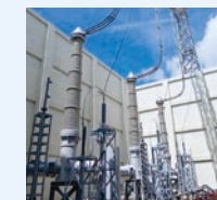
志賀中能登線ケーブル接続状態
