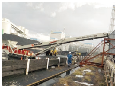
新たに設置した石炭簡易払出機
