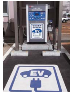
急速充電装置（小松支社）
