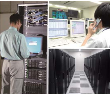
左：システムオペレーション作業の様子（北電情報システムサービス） 右上：通信回線の運用監視作業の様子（北陸通信ネットワーク） 右下：データセンターのハウジングラック群（パワー・アンド・IT）
