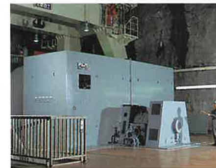
▲有峰第三発電所 当社で唯一の地下式水力発電所
