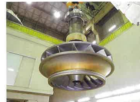
▲有峰第一発電所 ランナ
