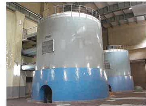
▲和田川第二発電所 1・2号発電機室
