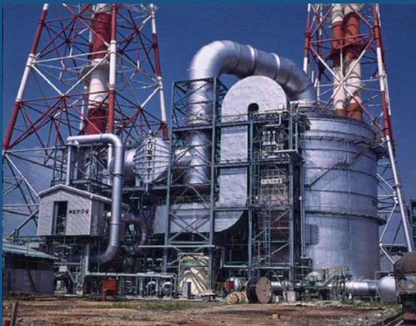
富山新港火力発電所 排煙脱硫装置
