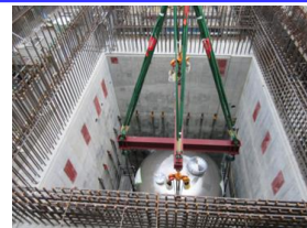
格納容器フィルタ付ベント装置の設置 (2015年7月)
