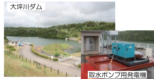
取水ポンプ用発電機
