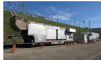
大容量電源車 [4,000kVA] (1号機用：1台, 2号機用：1台)
