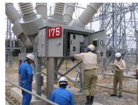
【使用前自主検査(変電)】
