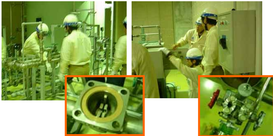
【模擬異常例：弁体の脱落】
