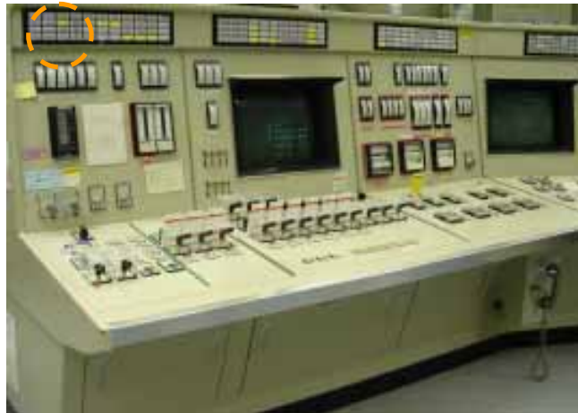
志賀原子力発電所 1号機 中央制御室の主盤
