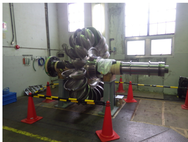
尾口発電所 3号水車羽根車（ランナ）
