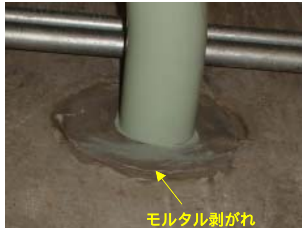
原子炉建屋地下1階 原子炉冷却材浄化系再生熱交換器室
