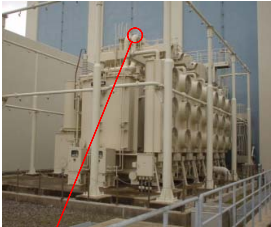
1号機主変圧器
