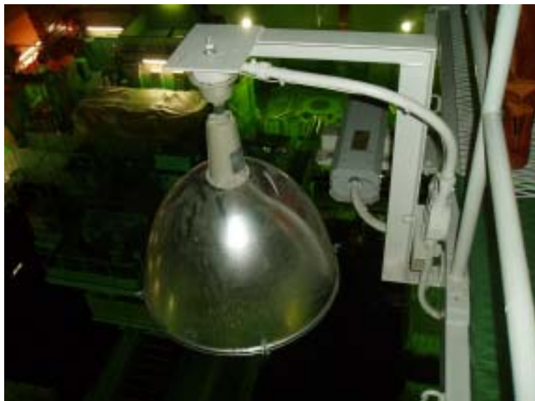
健全な水銀灯
