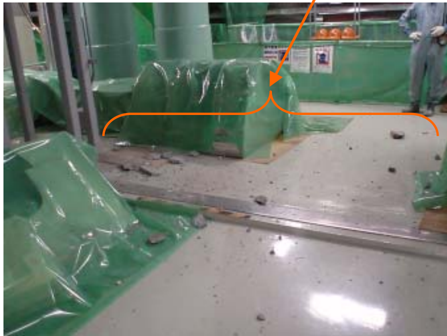
コンクリート片が床に落下した状況
