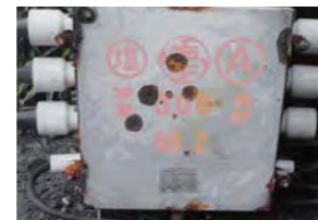
経年劣化により、錆が発生（施設後約10年経過）
