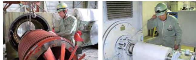
高圧電動機の点検
