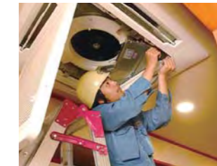
空調設備メンテナンス
