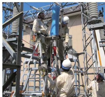
変電部門技能競技会
