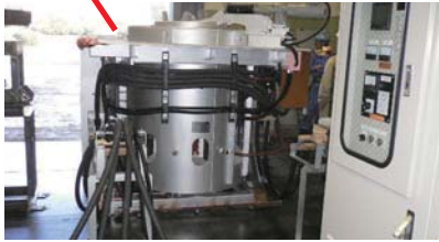
150kW誘導加熱溶融炉
