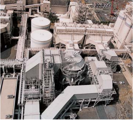
排煙脱硫装置(敦賀火力発電所)
