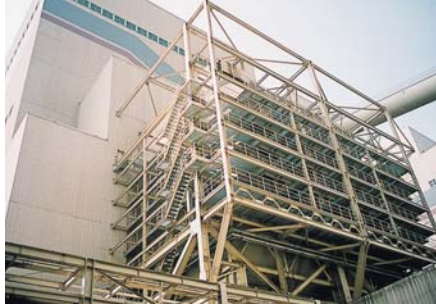
排煙脱硝装置(敦賀火力発電所)
