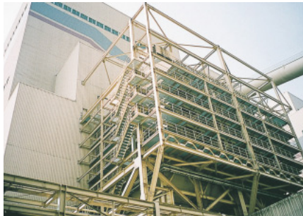
排煙脱硝装置(敦賀火力発電所)
