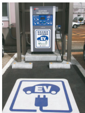
急速充電装置
