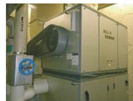
空調機ダンパの開度調整
