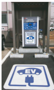
急速充電装置
