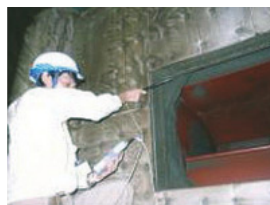
空調ダクトの風量測定
