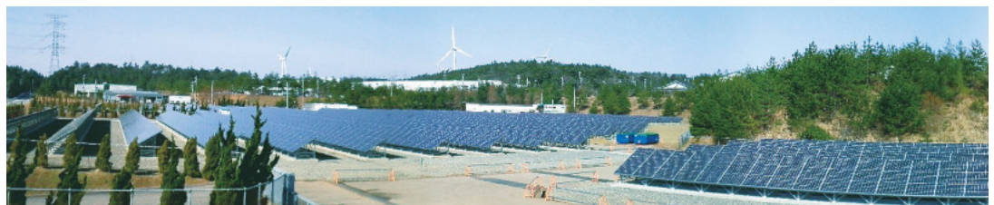
志賀太陽光発電所
