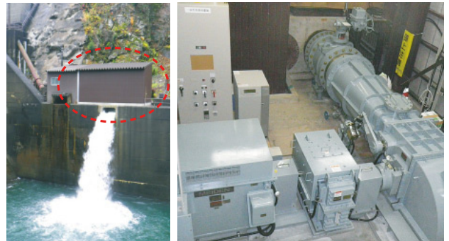
仏原ダム発電所(右：発電所内部)
