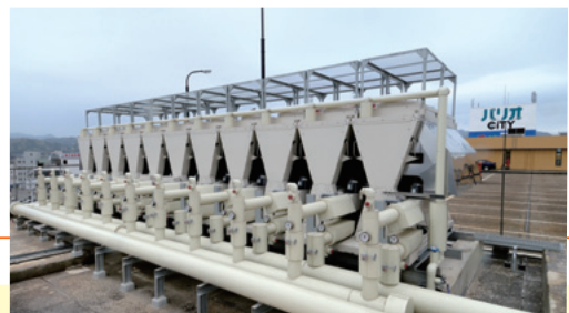
ヒートポンプ
