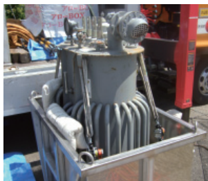
高濃度PCBを含む高圧変圧器
