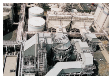
排煙脱硫装置(敦賀火力発電所)
