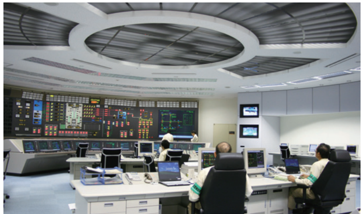
中央制御室(2号機)
