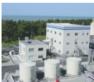
絶縁油処理施設
