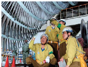
火力発電所定期検査
